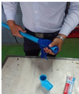
แสดงการทำความสะอาดท่อพีวีซีด้วยน้ำยาทำความสะอาด
